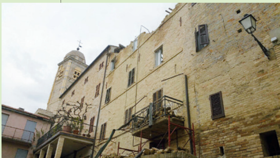
Particolare della facciata pericolante di uno dei palazzi in “zona rossa”
